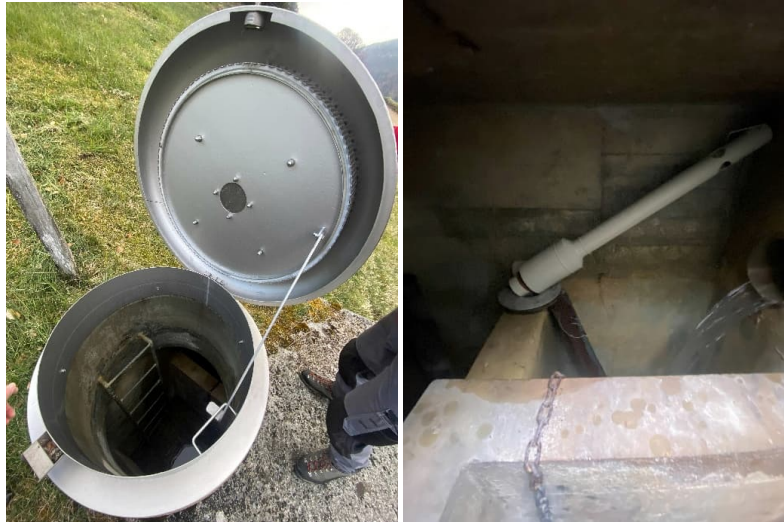
Figure 4 : Captage des Teureux, extérieur et intérieur
